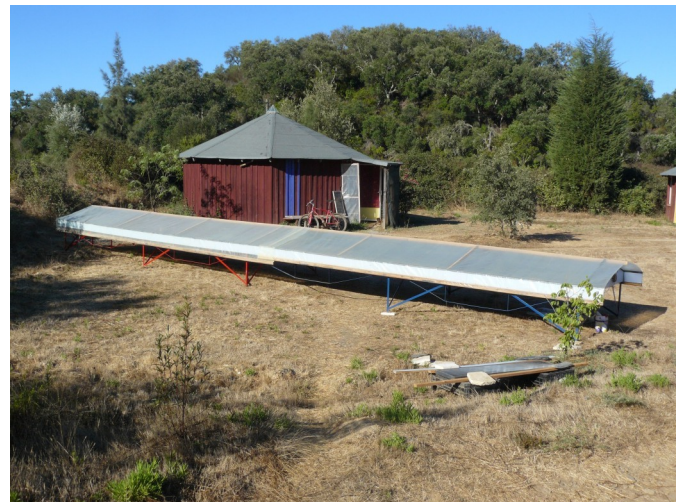
Ein Solarpanel und 3 Ventilatoren sorgen für genügend Lüftung
